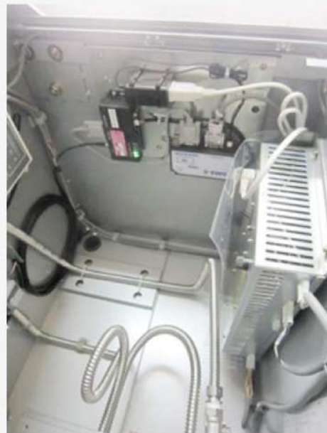
図 自動販売機に組み込んだ通信装置
